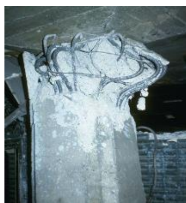
Fig. 18. Rotura por aplastamiento, pandeo de las armaduras
