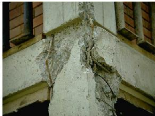
Fig. 16. Rotura con pandeo de las armaduras
