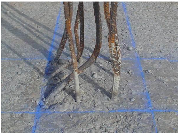
Fig. 3. Deficiente replanteo y grifado de armaduras
