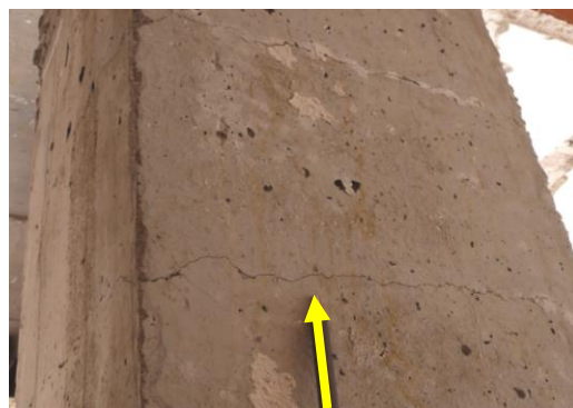
Fig. 6. Fisuración por retracción en soportes
