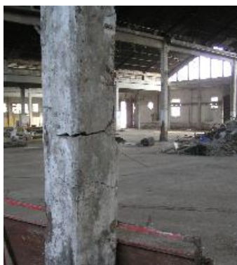
Fig. 13. Rotura a flexión por pandeo de soporte
