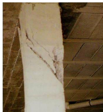
Fig. 14. Grieta por cortante en soporte
