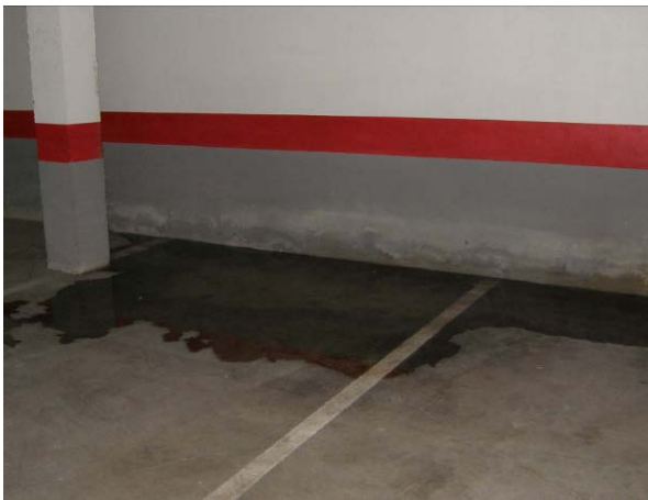
Fig. 3: Filtración por el encuentro solera-muro.
