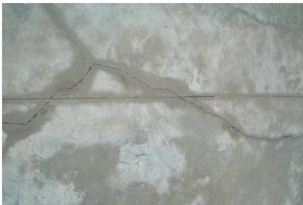
Fig. 5: Fisuraciones de retracción en solera
