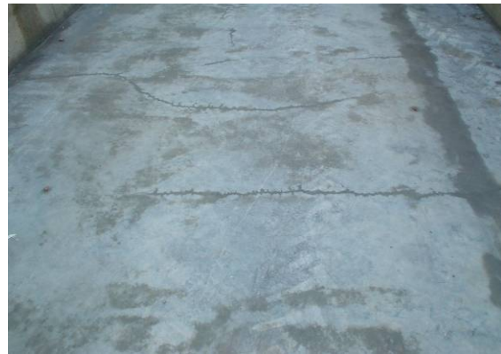
Fig. 2: Fisuraciones en solera de hormigón
