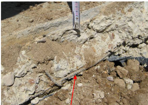
Fig. 3: Incorrecta colocación del armado.
