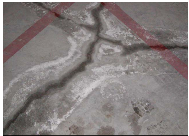
Fig. 4. Humedades de filtración por fisuras en solera
