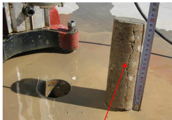
Fig. 6: Fisura en solera Testigo de hormigón
