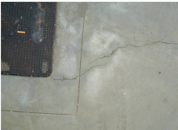
Fig. 5: Fisuración por deficiente diseño de juntas o incorrecta ejecución
