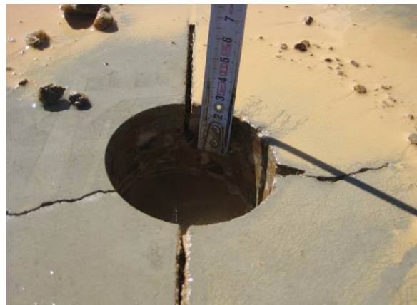
Fig. 4: Fisuración de retracción, deficiente serrado
