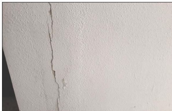
Fig. 5: Fisuración vertical en un revestimiento interior de yeso acabado con pintura al gotelé
