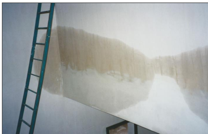
Fig. 10: Filtración de agua de una cubierta afectando a un guarnecido
