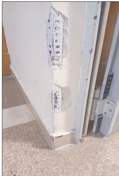
Fig. 9: Rotura por impacto de la esquina de un enyesado quedando a la vista el guardavivros de PVC
