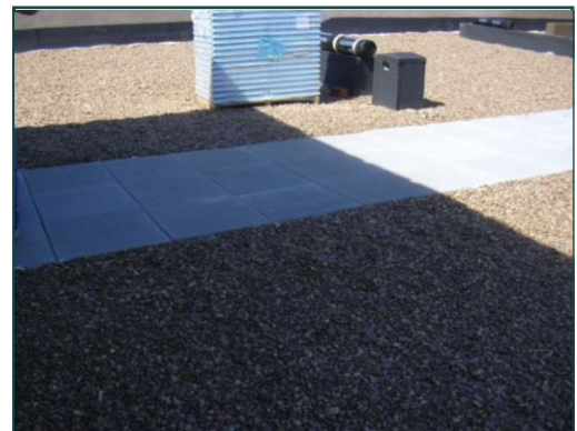
Fig. 3: Ejemplo de pasillo de mantenimiento
