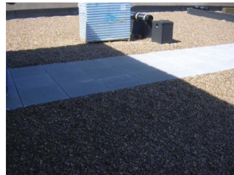
Fig. 3: Ejemplo de pasillo de mantenimiento
