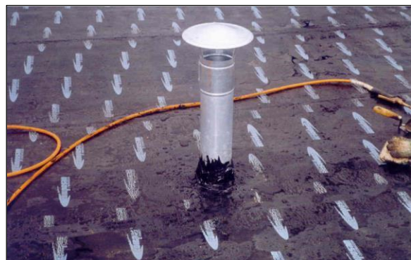
Fig. 2: Ejecución incorrecta de encuentro directo lámina-shunt
