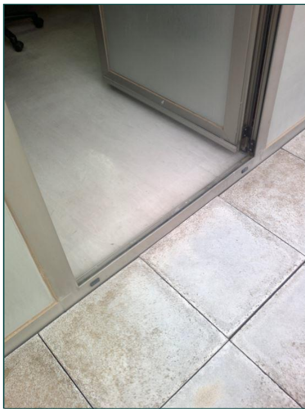
Fig. 7: Ejemplo de puerta de acceso a una cubierta plana transitable que no cumple con la altura de protección que indica el CTE. La cota del solado exterior es igual a la del suelo interior, por lo que las posibilidades de entrada de agua se multiplican.
