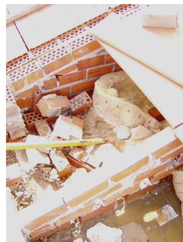
Fig. 3: Ejecución no cuidada de formación de pendiente con falta de limpieza, deterioro del aislante, colocación del papel kraft a la inversa....
