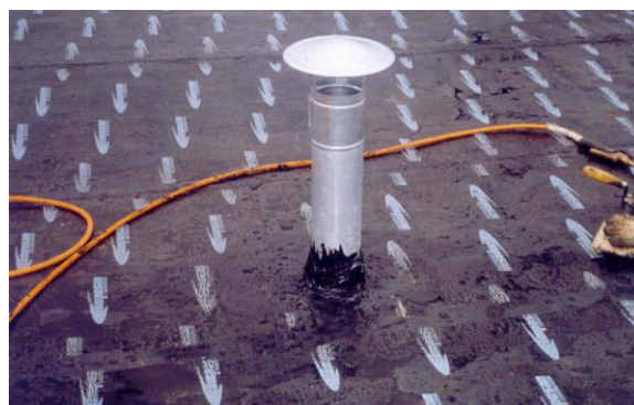
Fig. 2: Ejecución incorrecta de encuentro directo lámina-shunt
