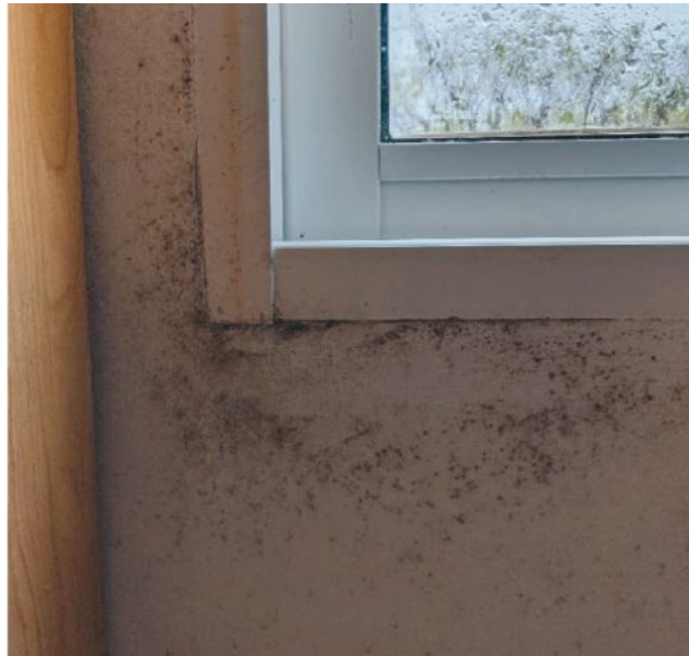
Imagen 5.5: Patología a consecuencia de puente térmico (fuente: los autores).
