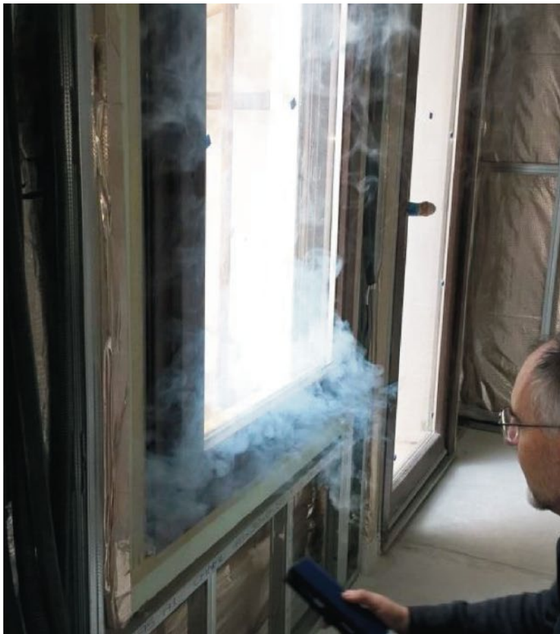
Imagen 5.7: Búsqueda de infiltraciones (fuente: Termagraf).
