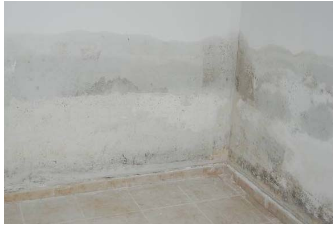
Fig. 4: Humedades en hoja interior de la cámara bufa
