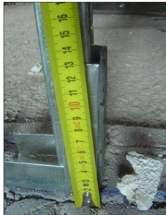
Fig. 8: Comprobación del largo de la patilla de la canal inferior de un tabique en su encuentro con un hueco de paso. Su longitud es menor a lo indicado en la norma UNE.
