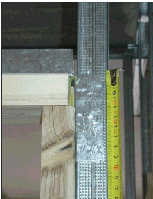
Fig. 7: Patilla de la canal de dintel de una puerta. Su longitud es un 40% menor que el mínimo posible, y además, no tiene las 2 fijaciones mecánicas preceptivas.
