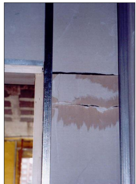
Fig. 6: Proceso de ejecución incumpliendo varios criterios: ancho excesivo de la junta entre placas, falta de colocación de un perfil horizontal sobre el que atornillar y rotura de una de las placas.
