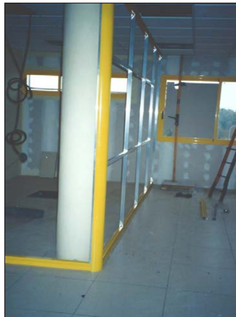
Fig. 7: Proceso de montaje de una tabiquería modular con subestructura portante metálica. Las esquineras, piezas de cornisa y piezas de rodapiés son de aluminio lacado, mientras que los perfiles interiores modulares son de aluminio anodizado.
