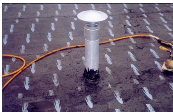
Fig. 2: Ejecución incorrecta de encuentro directo lámina-shunt
