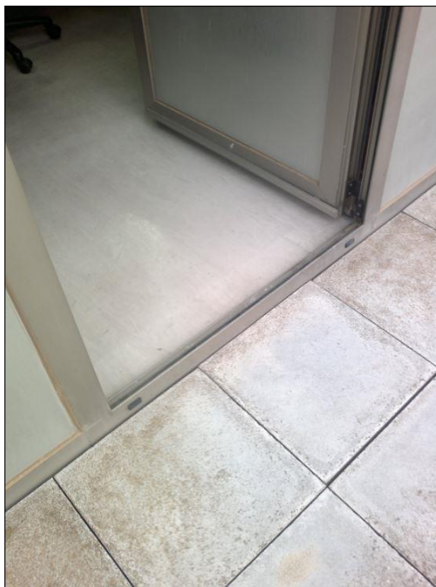
Fig. 7: Ejemplo de puerta de acceso a una cubierta plana transitable que no cumple con la altura de protección que indica el CTE. La cota del solado exterior es igual a la del suelo interior, por lo que las posibilidades de entrada de agua se multiplican.
