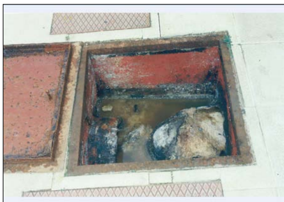
Fig. 1: Rotura de sifón (codo PVC) por entrapo en este punto
