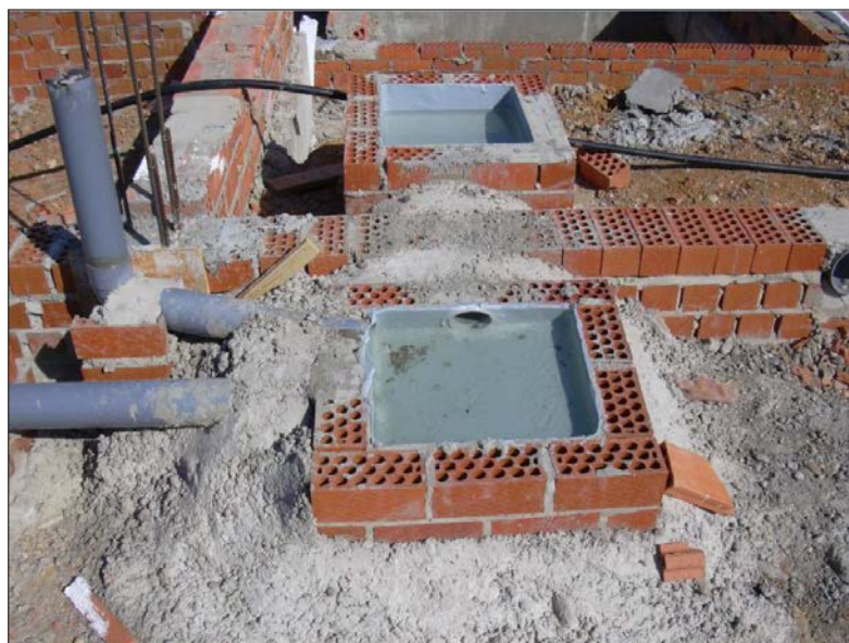
Fig. 5: Prueba de estanqueidad parcial de una red de saneamiento horizontal realizada mediante llenado de agua. Puede apreciarse también el macizado exterior con hormigón del encuentro entre tuberías y arquetas.
