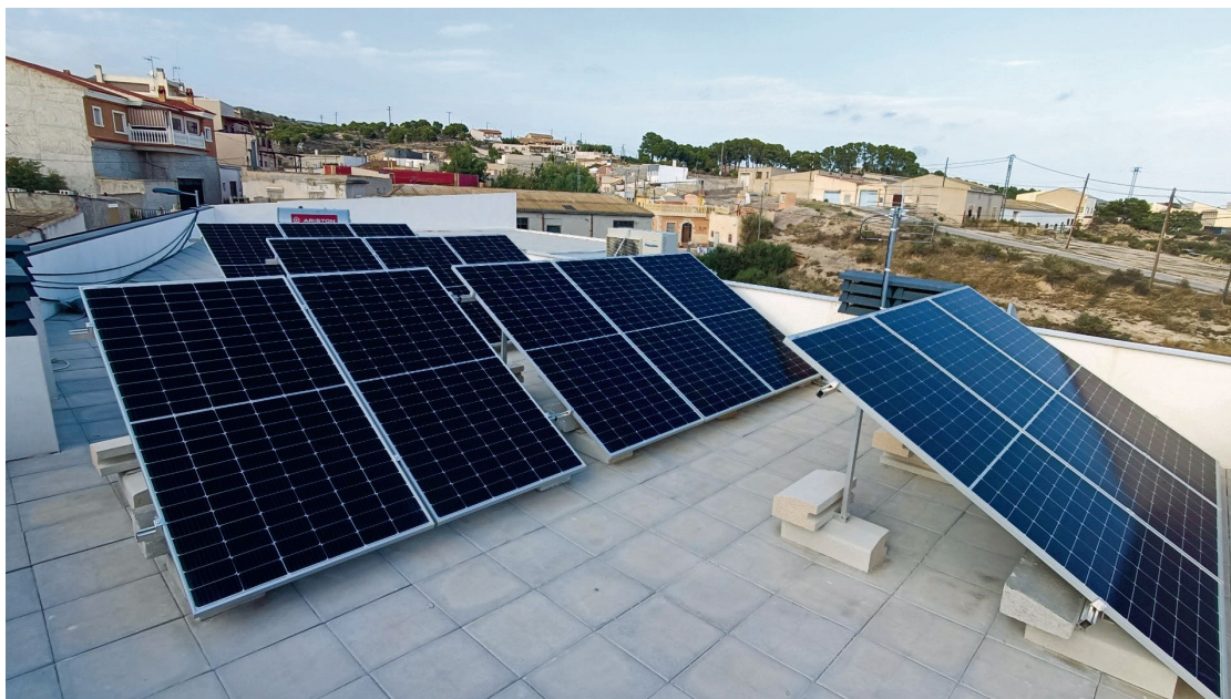
Figura 20. Vista de una cubierta de una vivienda unifamiliar con placas solares fotovoltaicas en primer plano y con una placa solar térmica al fondo (solo se observa el depósito de almacenamiento).
