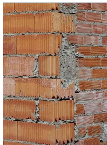
Fig. 7: Esquina de fachada donde converge el sistema Termoarcilla® y el tradicional de ladrillo. Se aprecian cortes inadecuados de piezas, macizados con cemento y enjarjes insuficientes.
