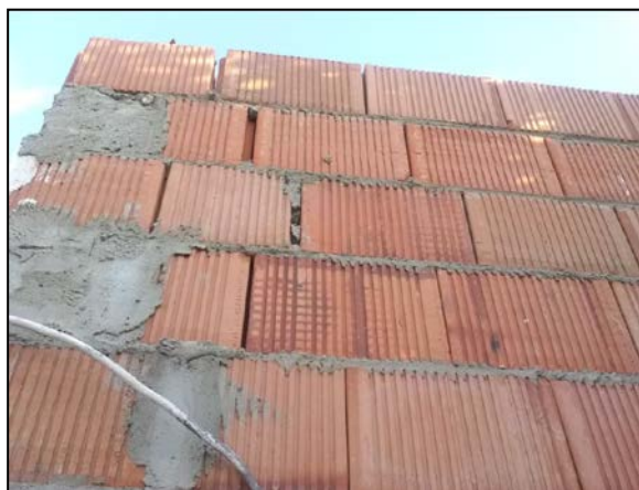
Fig. 4: Aberturas de encaje de las juntas verticales con espesores diferentes y con la inclusión en algún otro caso de mortero de cemento (incorrecto)
