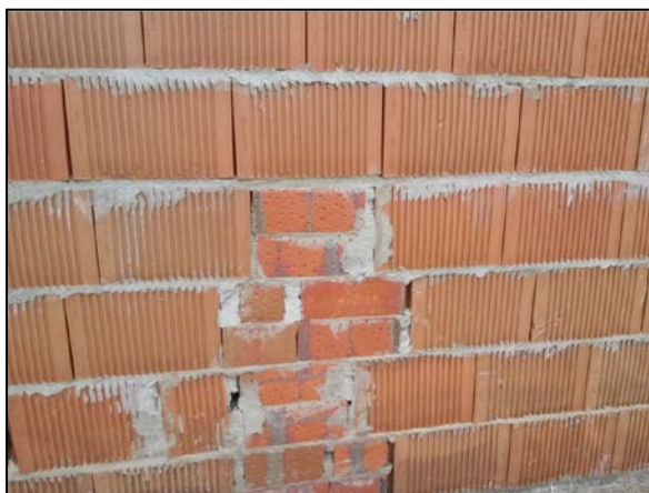
Fig. 3: Inclusion de varios ladrillos perforados entremezclándolos en una fábrica de bloques cerámicos aligerados (incorrecto)
