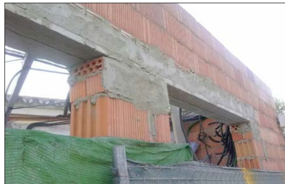
Fig. 2: Apoyos inadecuados bajo dinteles realizados con ladrillo
