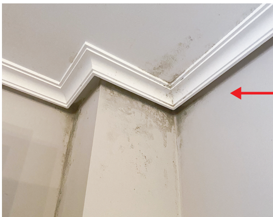
Imagen 77. Pilar en esquina sin aislamiento.
