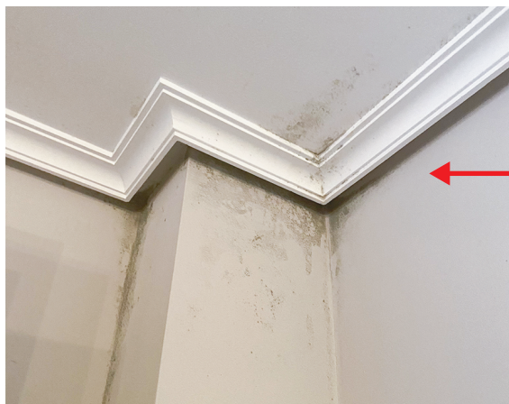
Imagen 77. Pilar en esquina sin aislamiento.
