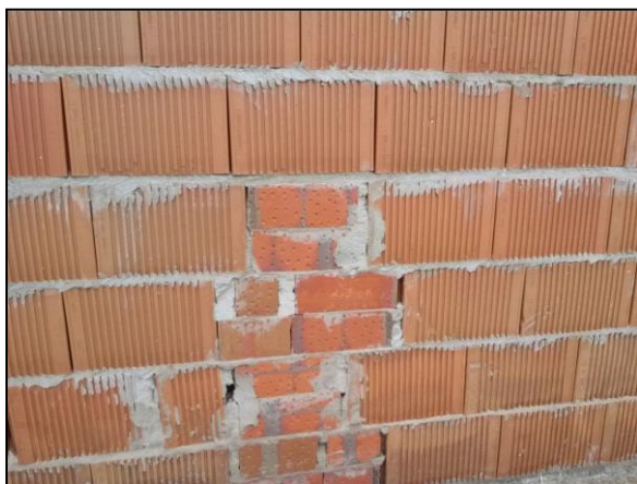
Fig. 3: Inclusión de varios ladrillos perforados entremezclándolos en una fábrica de bloques cerámicos aligerados (incorrecto)
