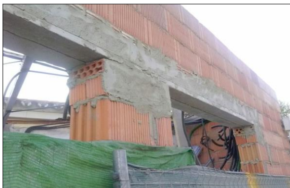
Fig. 2: Apoyos inadecuados bajo dinteles realizados con ladrillo
