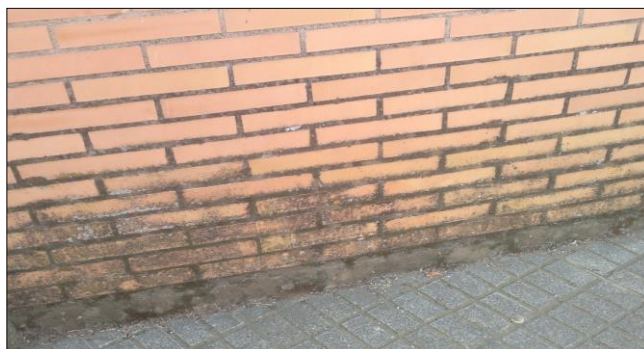
Fig. 11: Humedad en la parte inferior de una fachada cara vista debido a la falta de zócalo
