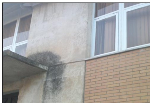
Fig. 8: Humedad debida a una solución inadecuada entre la fachada y el alero de hormigón
