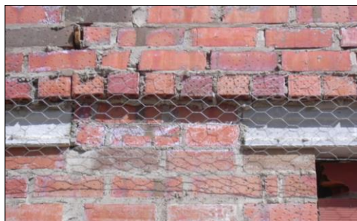
Fig. 6: Solución (mal ejecutada) en la que el dintel se realiza con vigueta doble T y se adiciona una malla metálica con solape en vertical insuficiente.
