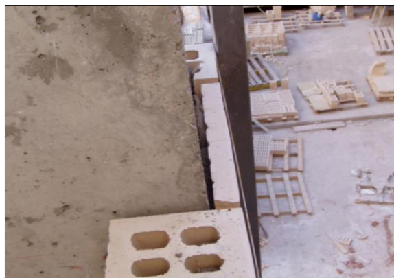
Fig. 1: Espesor insuficiente del emparchado de un pilar
