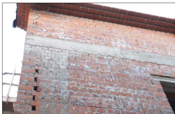
Fig. 2: Deficiente ejecución de fachada de 1 pie de espesor
