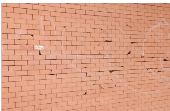
Fig. 2: Fábrica con junta oculta y existencia de desportillados
