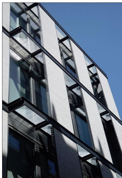
Fig.10: Fachada con vidrio termoacústico y paneles exteriores de granito sujetos a perfiles metálicos para dotar al edificio de sombreado
