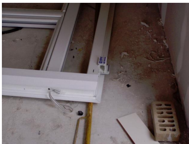
Fig. 9: Ventana mal acopiada y situada en el suelo sin cuidado, antes del proceso de su fijación en la fábrica de fachada.
