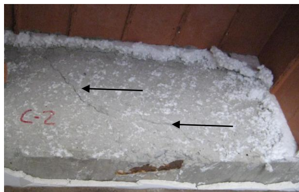
Fig. 19. Fisuración en viga por esfuerzo cortante
