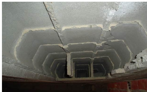
Fig. 14. Rotura y desprendimiento de bovedillas de hormigón por deformaciones diferenciales
