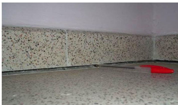
Fig. 10. Separación tabique-solado por deformaciones diferenciales o excesivas de forjado
