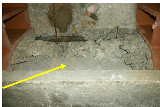
Fig. 8. Deficiente vertido y compactado del hormigón entre vigueta y bovedilla
