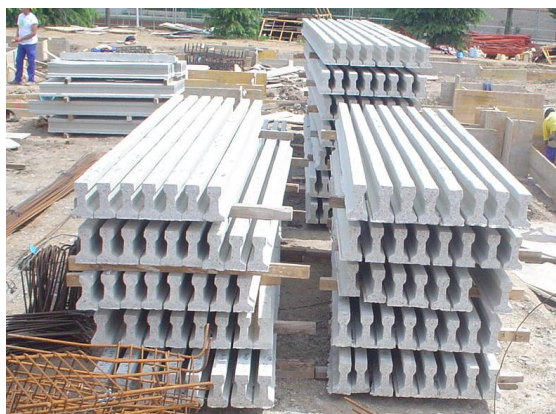
Fig. 4. Acopio de viguetas sin identificación
