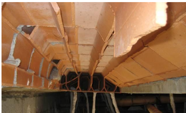
Fig. 13. Rotura y desprendimiento de bovedillas cerámica por expansión de humedad
