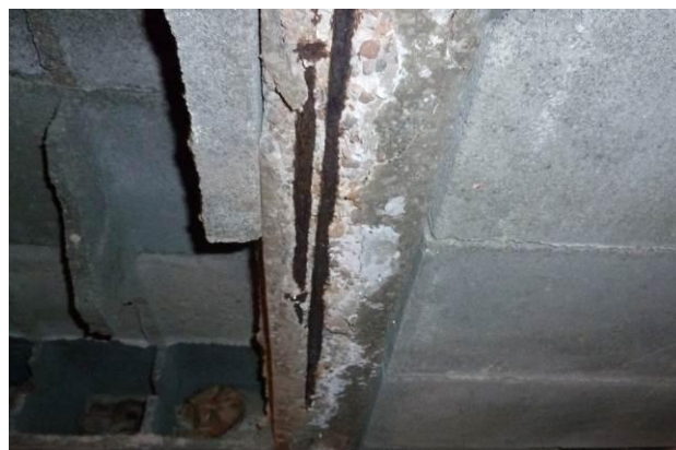
Fig. 17. Desprendimiento del hormigón de vigueta por corrosión de armaduras
