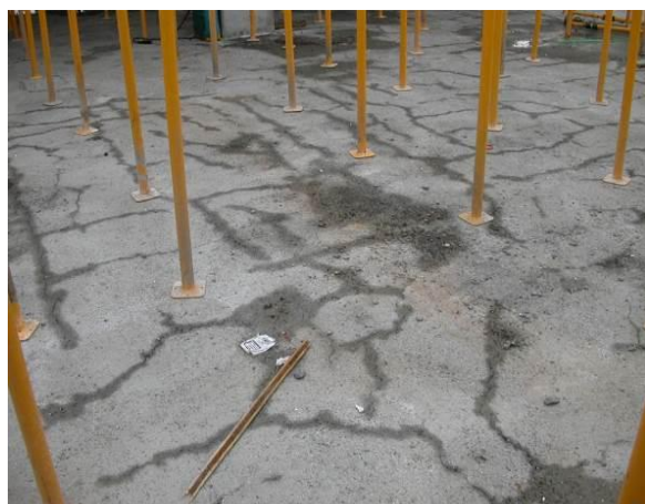
Fig. 15. Fisuración por retracción hidráulica
