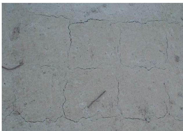
Fig. 16. Fisuración por asiento plástico
