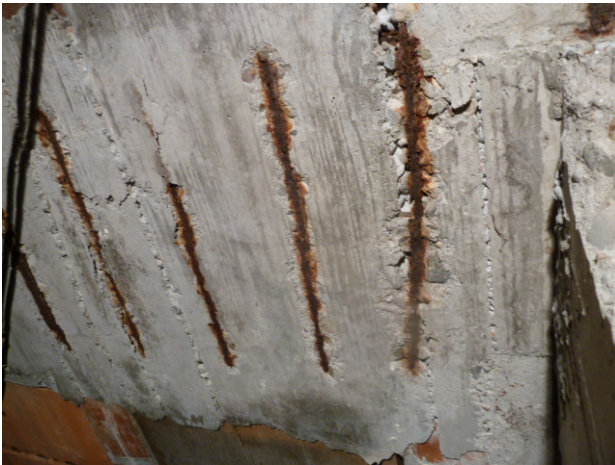
Fig. 4 Deficiente recubrimiento. Corrosión de la armadura
