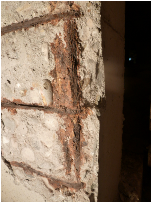
Fig. 5: Corrosión de las barras corrugadas de un pilar. Condiciones ambientales. Carbonatación
