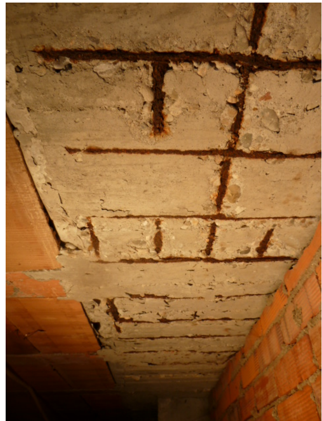
Fig. 6: Corrosión del armado de una viga pilar. Ausencia recubrimiento
