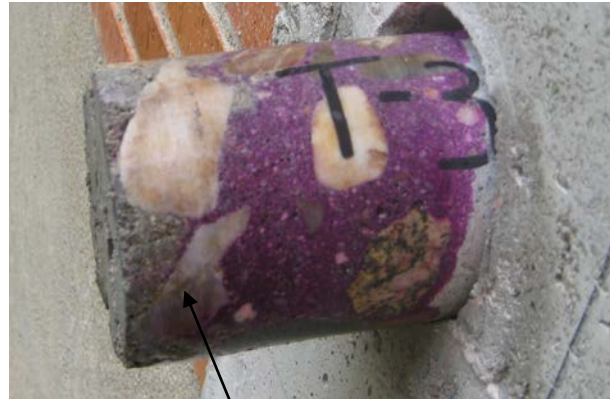
Fig. 2: Carbonatación del hormigón
