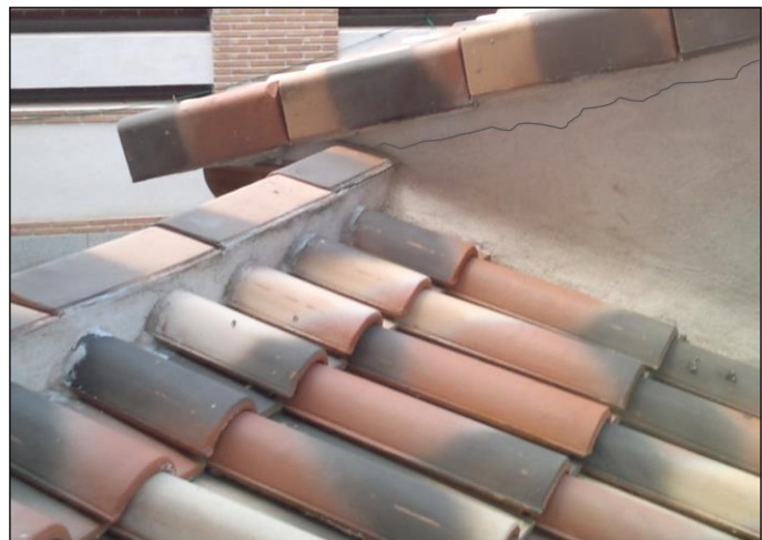
Fig. 4: Fisura característica en la parte superior del borde lateral de una cubierta inclinada (bajo pieza especial de remate).
