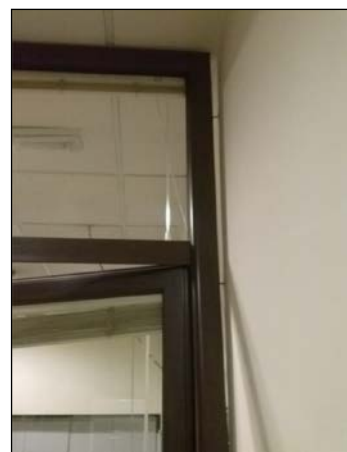
Fig. 9: Encuentro entre carpintería y una pared dejando una holgura excesiva entre ambos elementos.
