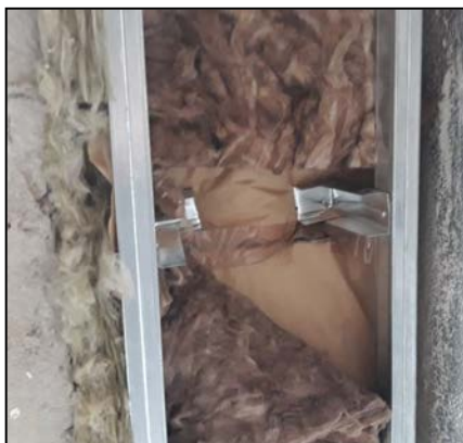
Fig. 8: Colocación del aislamiento en un trasdosado mediante la disposición de dos paneles de lana mineral. La barrera de vapor se ha puesto indebidamente entre esos dos paneles.
