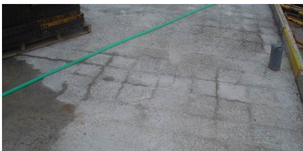
Figura 8: fisuras de retracción en losa de cimentación
