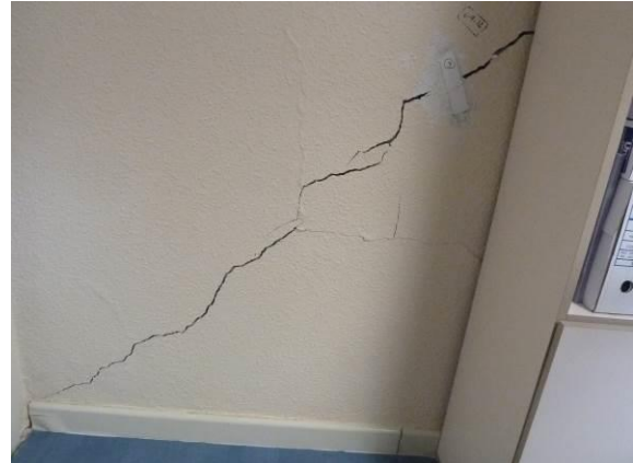
Figura 7: Fisuraciones por asientos de la cimentación
