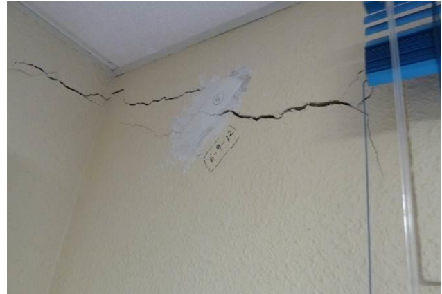
Figura 5: Cimentación en relleno. Asientos: fisuras/grietas
