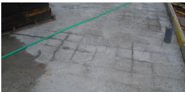
Figura 8: fisuras de retracción en losa de cimentación
