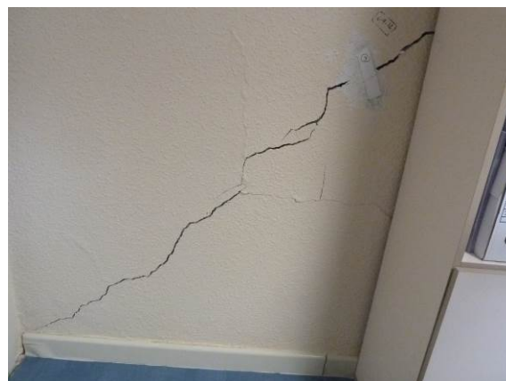
Figura 7: Fisuraciones por asientos de la cimentación
