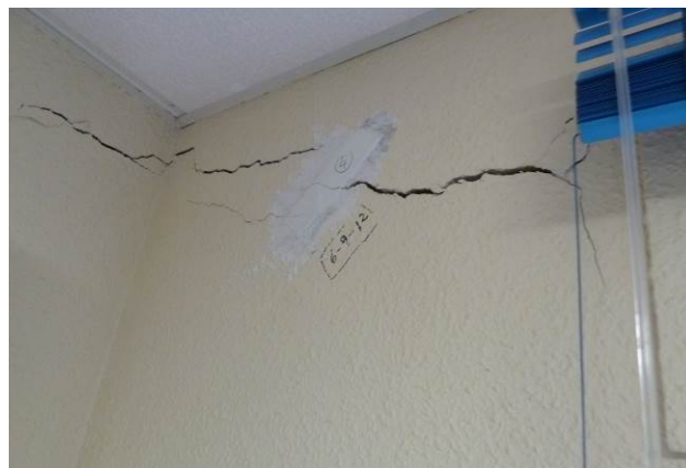
Figura 5: Cimentación en relleno. Asientos: fisuras/grietas
