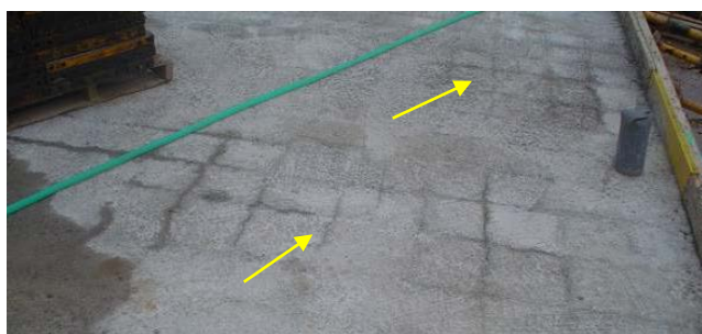
Figura 8: fisuras de retracción en losa de cimentación
