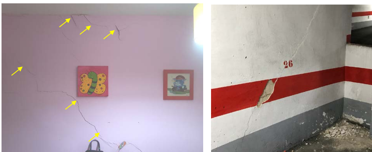
Figura 6: Daños por cimentación en terreno expansivos: fisuras y grietas
