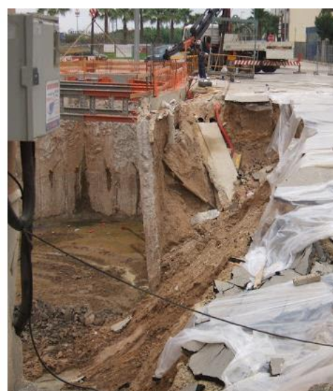
Fig. 4. Patología en pantalla
