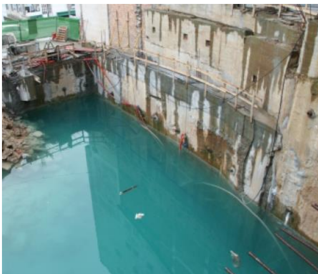
Fig. 3. Pantalla de hormigón. Efecto del agua
