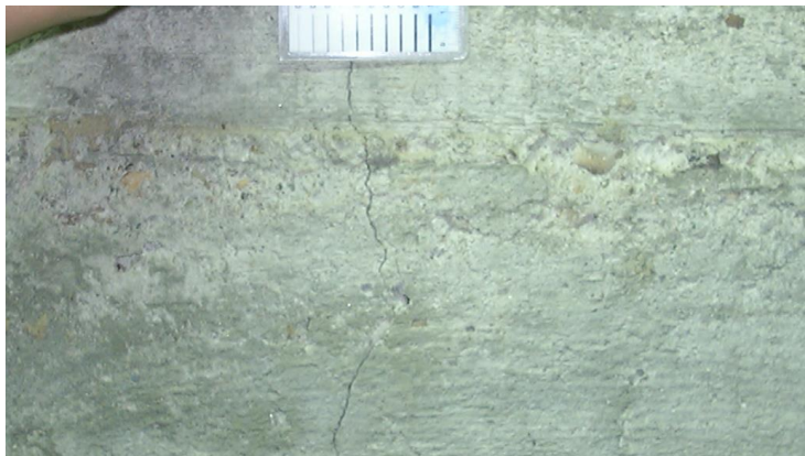
Figura 6. Fisuración por retracción en alzado de muro
