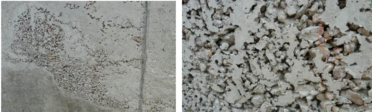
Figura 5. Nidos de grava en muros
