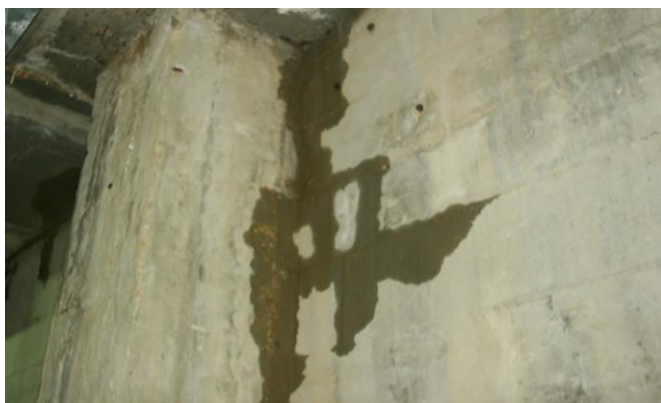
Figura 4. Muro de sótano. Filtración
