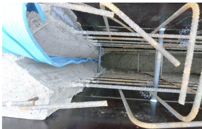
Figura 12. Junta de hormigonado y retracción
