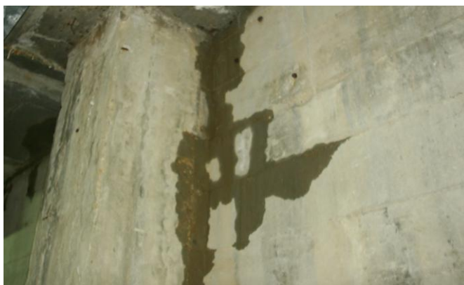
Figura 4. Muro de sótano. Filtración
