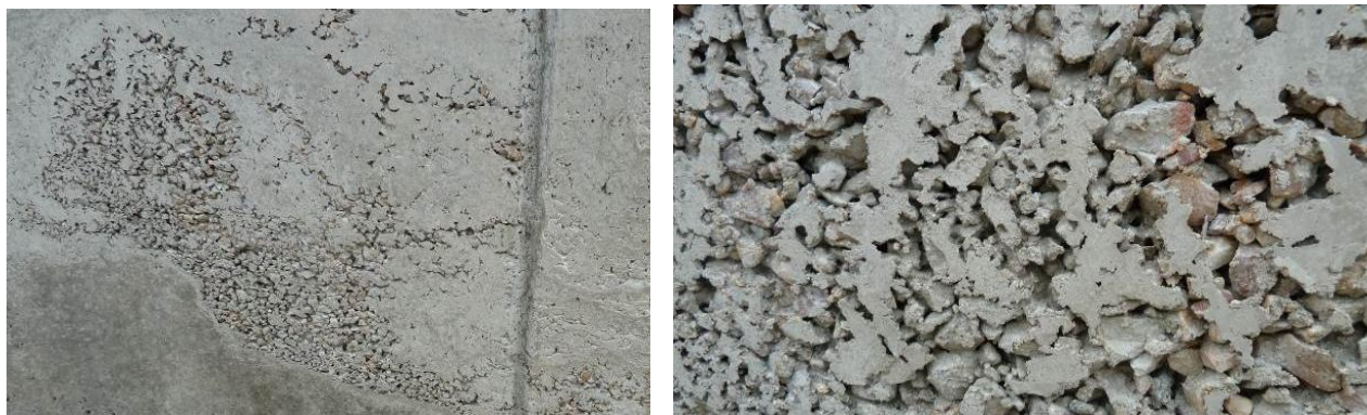
Figura 5. Nidos de grava en muros
