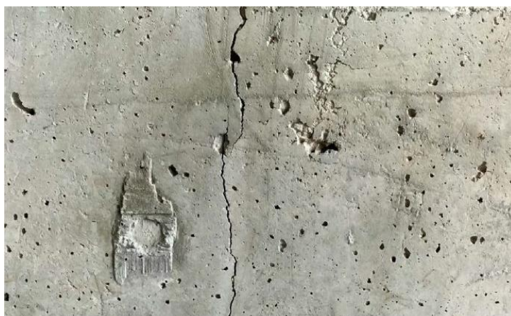
Figura 6. Fisuración por retracción en alzado de muro
