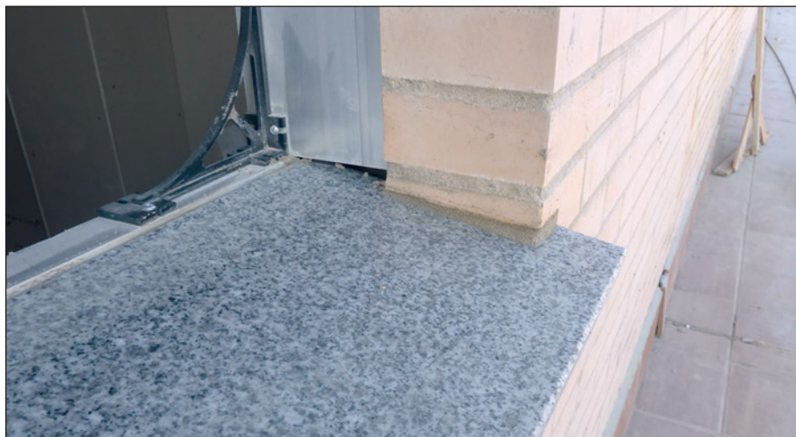
-Imagen G- Corte de muesca en el ladrillo para permitir el embudo lateral del vierteaguas. Se aprecia también que la base del prearco de ventana no tiene el corte inferior con la inclinación correcta.
