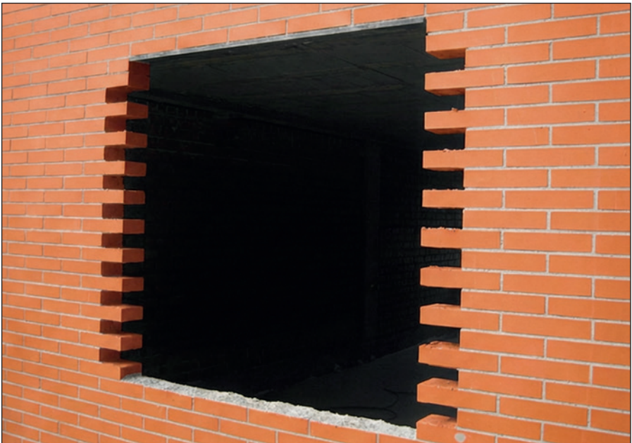
-Imagen E- Levantado de fábrica de ladrillo cara vista quedando el enjarje (endejas y adarajas) para disponer después el doblado de jambas hacia el interior.
