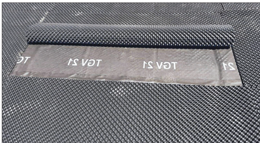
-Imagen M- Colocación de las subcapas especiales. Superiormente puede apreciarse una lámina nodulada de polietileno de alta densidad.
