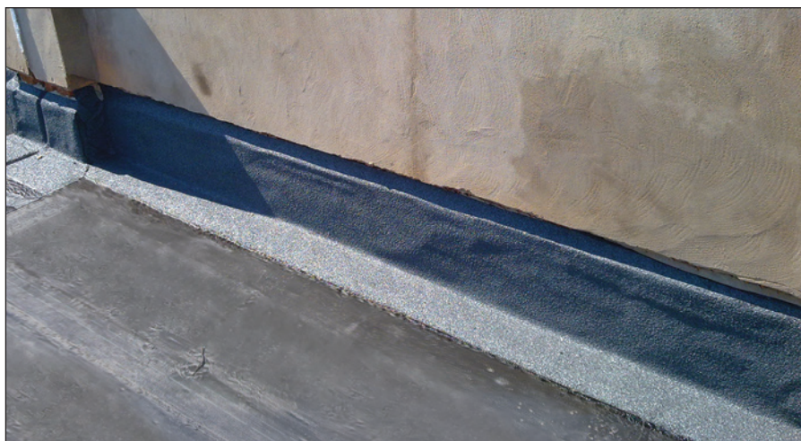
-Imagen H- Ejecución de membrana impermeabilizante ya finalizada. Se observa la lámina autoprotegida dispuesta en el perímetro de la cubierta (sobre la base del pretil).
