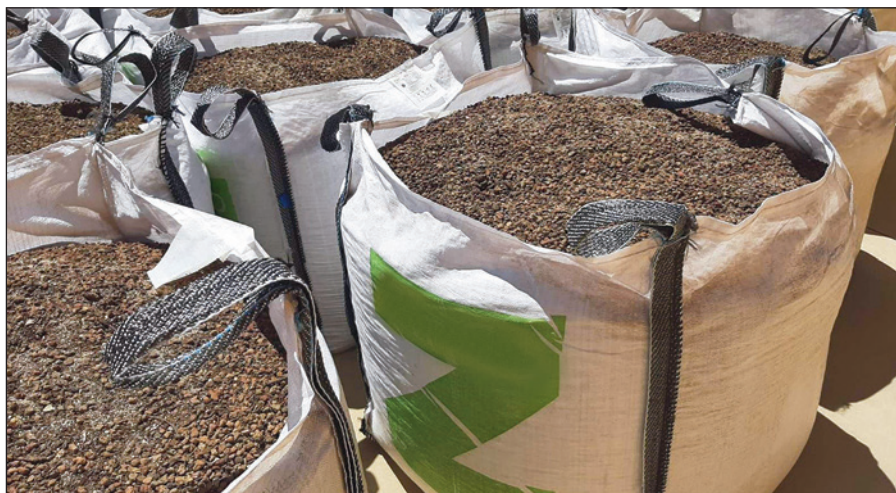
-Imagen C- Recepción en obra de diferentes sacos llenos de sustrato para una cubierta ajardinada.
