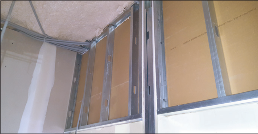
-Imagen J- Parte superior del hueco de dos puertas separadas por un tabique en perpendicular. Se aprecia que las canales no doblan a 90° para solapar sobre los montantes.
