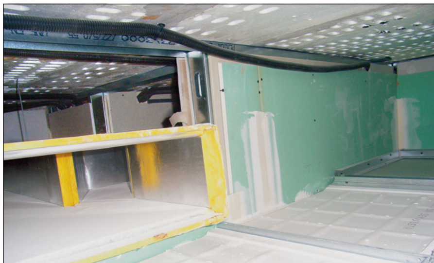
-Imagen I- Vista del plenum de entre un forjado y el falso techo. Se aprecia que el tabique no se ha cerrado en el tramo existente sobre el conducto de ventilación.
