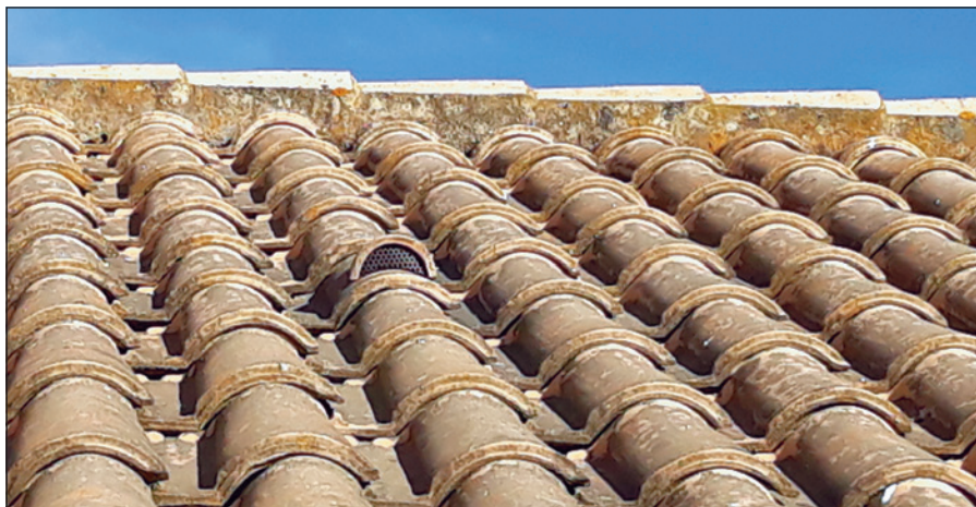
-Imagen K- Vista de la colocación de una teja de ventilación en un faldón de cubierta ya ejecutado.
