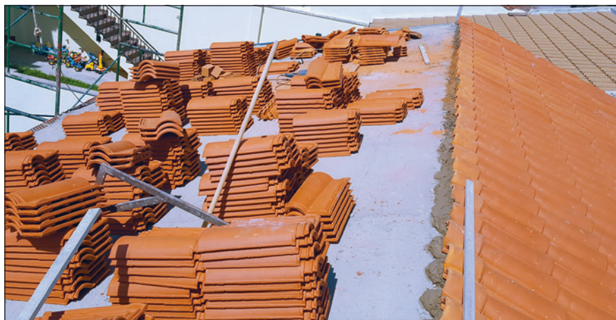
-Imagen E- Proceso de distribución y de colocación de las tejas sobre los faldones de cubierta.
