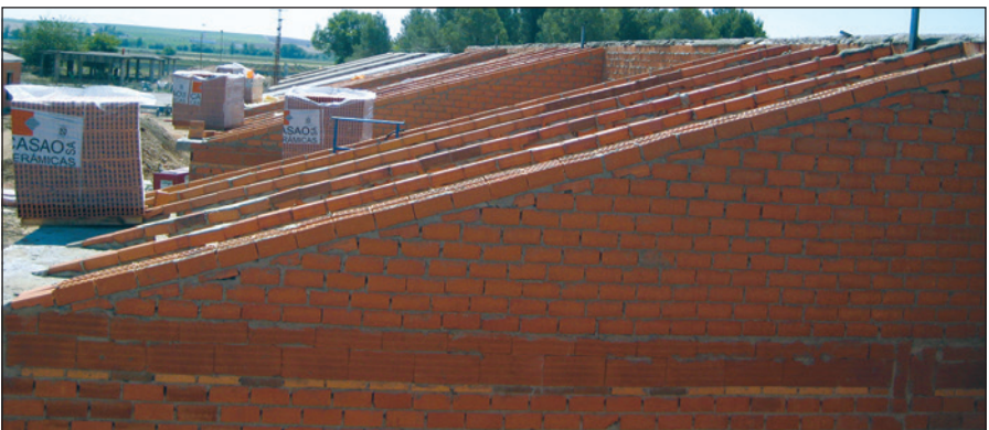
-Imagen N- Vista del lateral de una cubierta en ejecución: hastial realizado con fábrica de ladrillo perforado.
