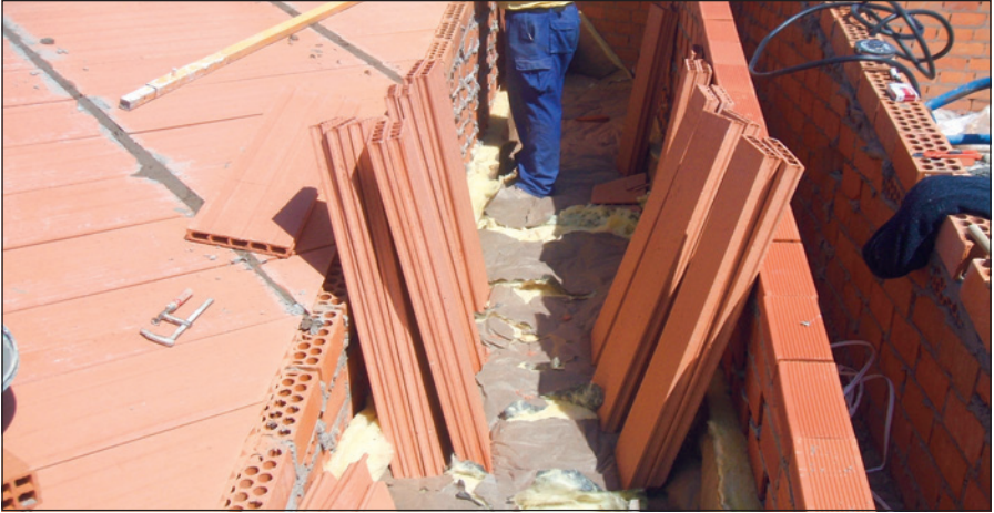
-Imagen S- Colocación del aislamiento de lana de vidrio con el papel kraft hacia arriba (error). Vista también del deterioro de dicho aislamiento por el pisoteo de los operarios.
