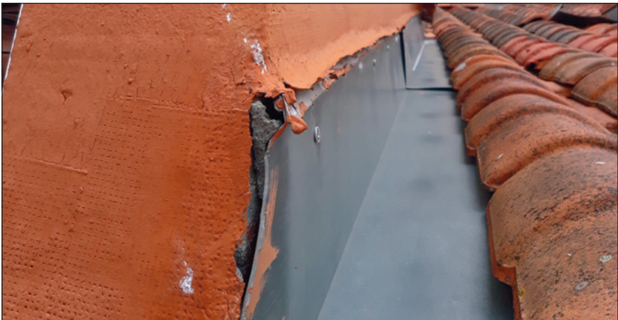
-Imagen D- Encuentro con un paramento vertical mediante la interposición de una canal lateral metálica. En este caso, debería tener más altura de protección y un mejor sellado de coronación.
