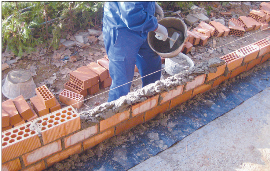
-Imagen B- Colocación de lámina impermeabilizante en el arranque de fachada en planta baja
