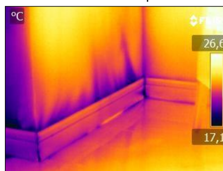
Fig. 3: Termografía del encuentro de una tabiquería de placa de yeso laminado con un solado. Se aprecian infiltraciones de aire.
