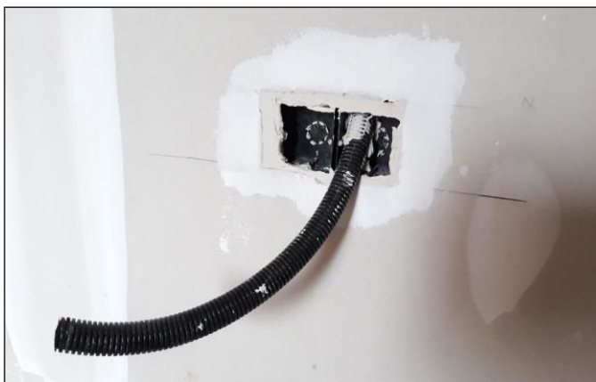
Fig. 14: Colocación de cajas para interruptores eléctricos. Ha sido necesario la reparación perimetral del hueco que los aloja debido a una mala puesta en obra.
