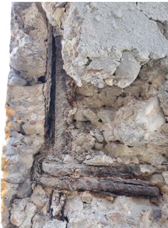
Fig. 7. Corrosión de las armaduras y desprendimiento del hormigón de un pilar.
