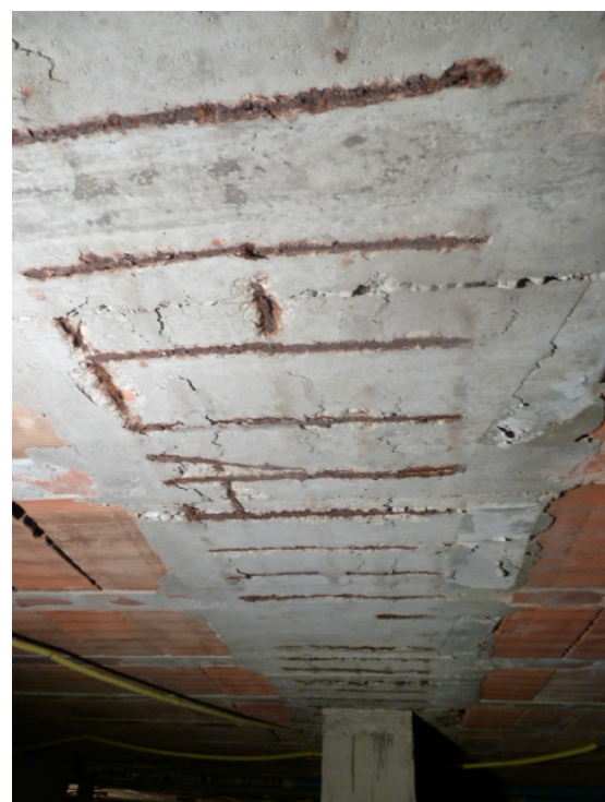
Fig. 8. Oxidación/Corrosión del armado inferior de viga de forjado. Deficiente recubrimiento del armado.
