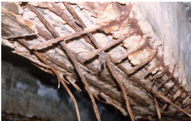
Fig. 10. Corrosión en el armado de viga por ataque de cloruros. Zona marítima
