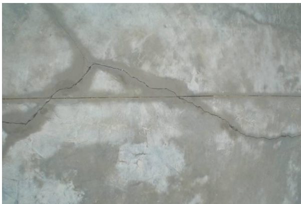
Fig. 5: Fisuraciones de retracción en solera
