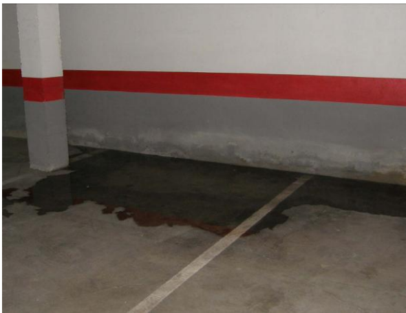
Fig. 7: Filtración por el encuentro solera-muro.
