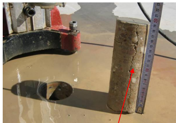
Fig. 6: Fisura en solera Testigo de hormigón
