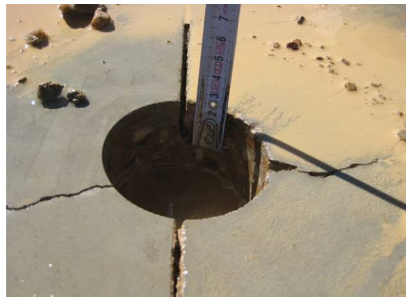
Fig. 4: Fisuración de retracción, deficiente serrado
