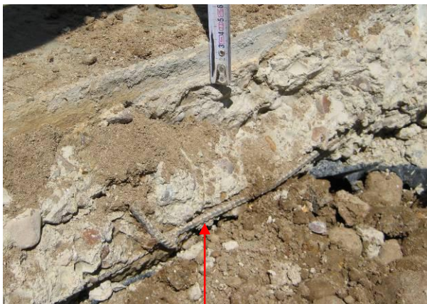
Fig. 3: Incorrecta colocación del armado.
