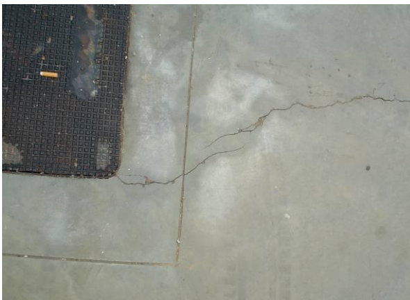
Fig. 9: Fisuración por deficiente diseño de juntas o incorrecta ejecución
