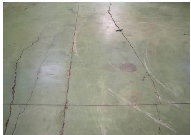
Fig. 10. Pérdida de apoyo localizado en la base
