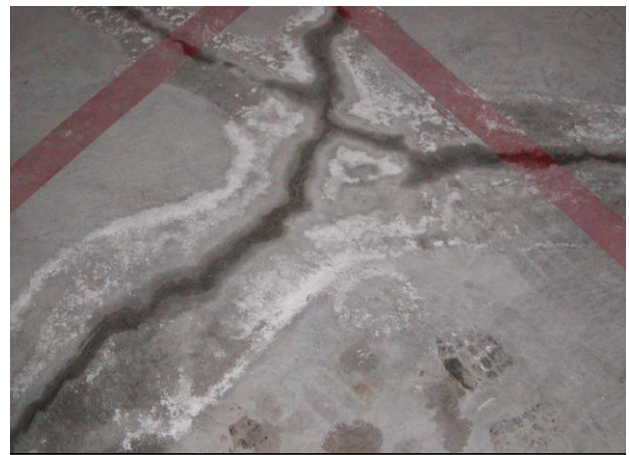
Fig. 8. Humedades de filtración por fisuras en solera
