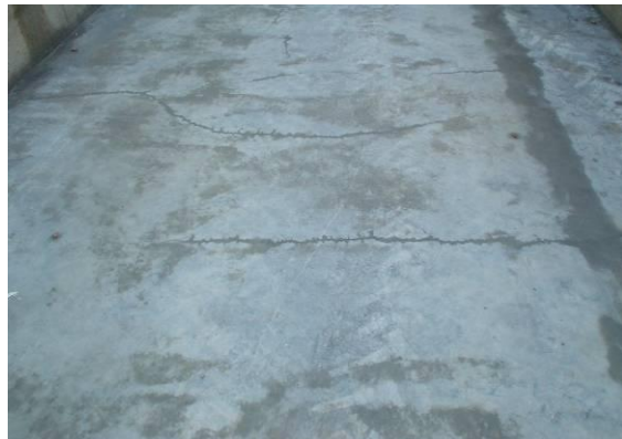
Fig. 2: Fisuraciones en solera de hormigón
