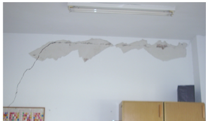
Figura 5: Cimentación en arcillas expansivas. Fisuras/grietas
