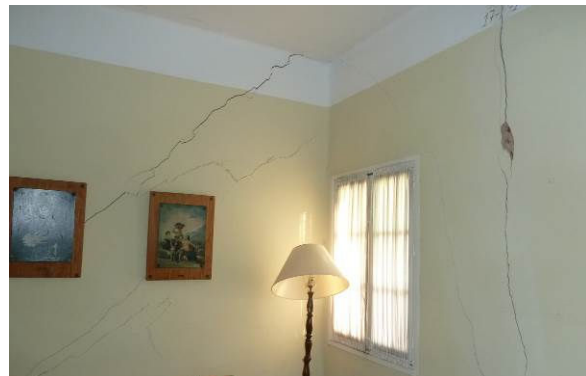
Figura 2: Lesiones por asientos de la cimentación
