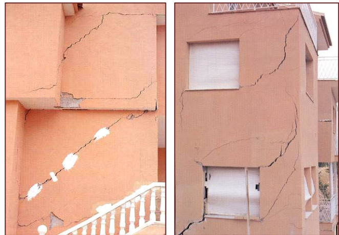
Figura 4: Cimentación en relleno. Asientos: Fisuras/grietas
