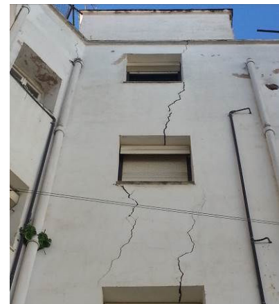
Figura 7: Fisuraciones por asentos de la cimentación
