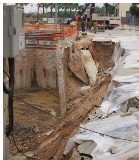
Fig. 4. Patología en pantalla
