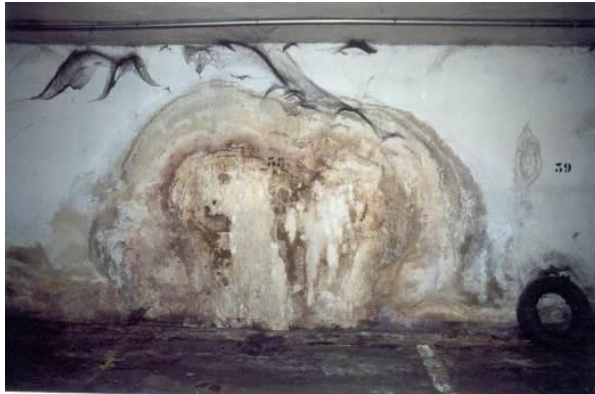
Fig. 3: Filtración a través de junta o fisuras
